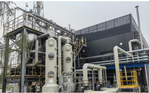
改造后:碱喷淋+水喷淋+树脂吸附
