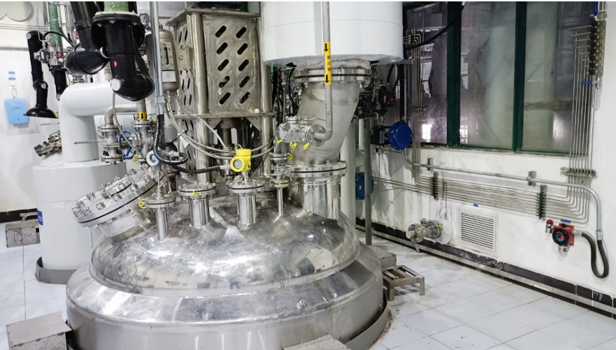
高浓废水分类预处理
